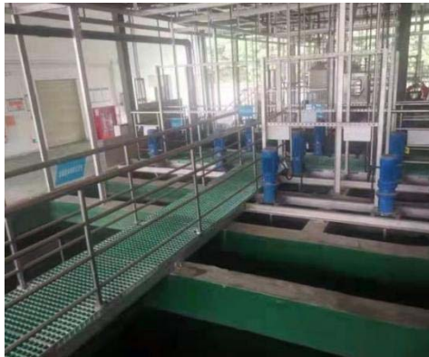
废水处理站照片 1
