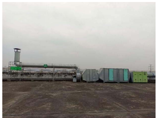
4#厂房：“二级活性炭吸附”装置
