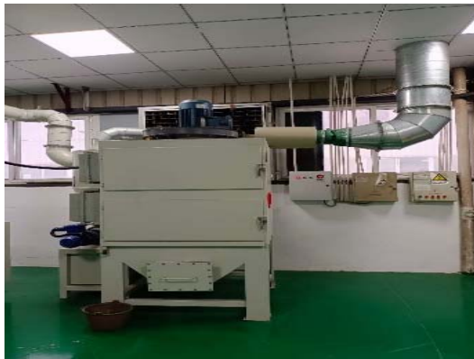
3#厂房：设备自带除尘系统
