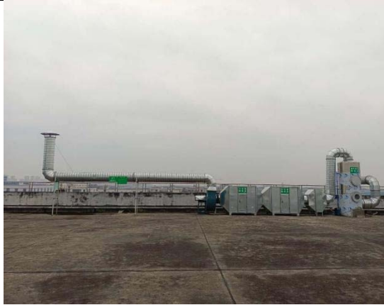
4#厂房：“水喷淋+脱水+二级活性炭吸附”装置
