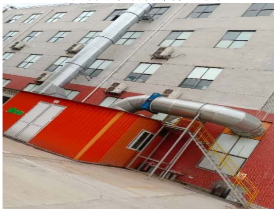
4#厂房：油雾净化器
