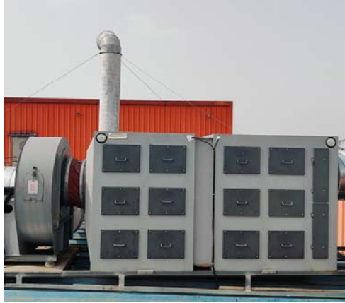
2#厂房：滤筒除尘器+两级活性炭
