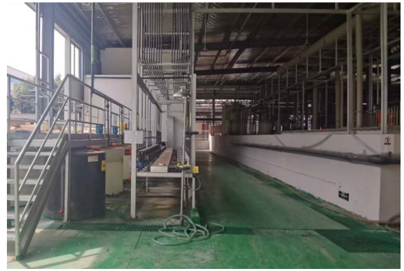
废水处理站照片 2
