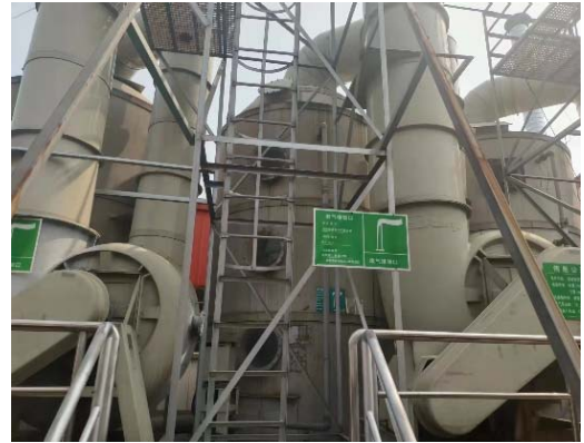
3#厂房：碱液喷淋塔
