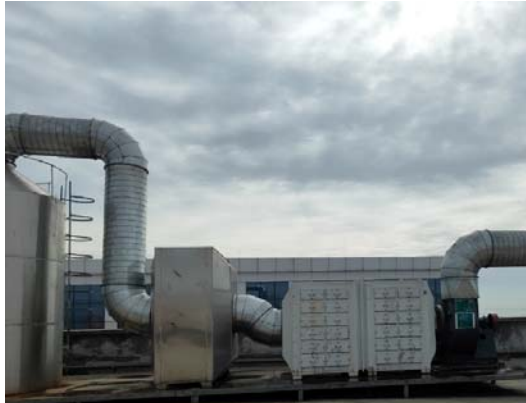
5#厂房“水喷淋+脱水+二级活性炭吸附”装置
