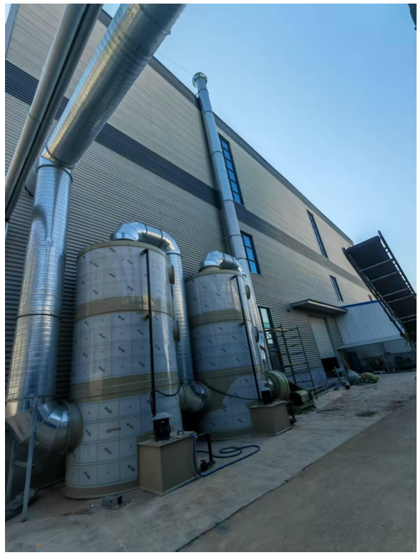
现有工程臭气处理措施
