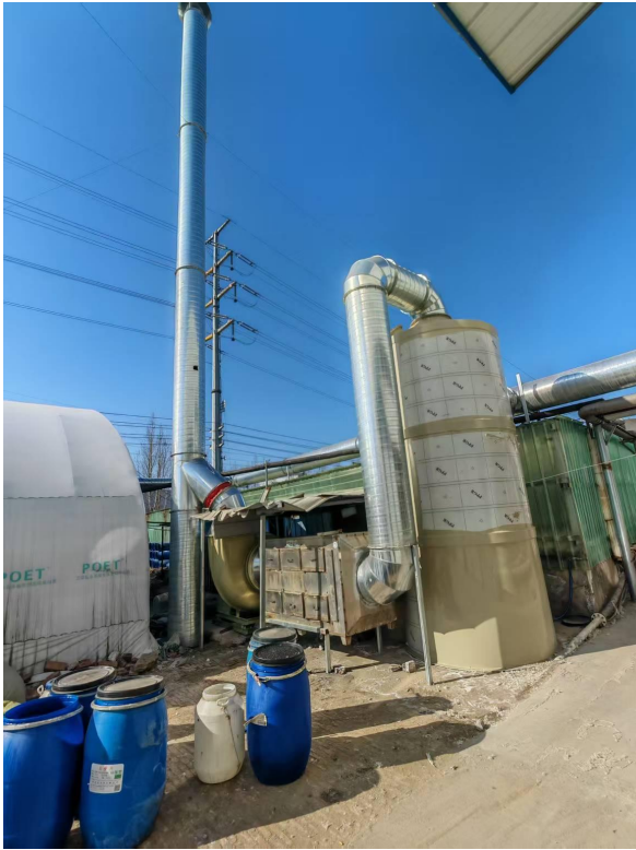
现有工程臭气处理措施
