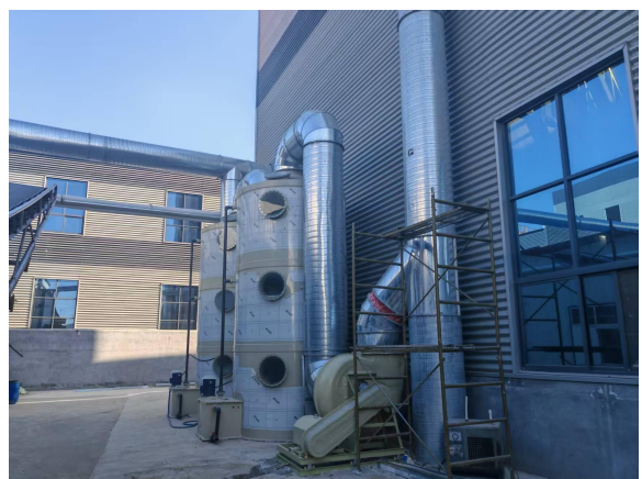
现有工程臭气处理措施
