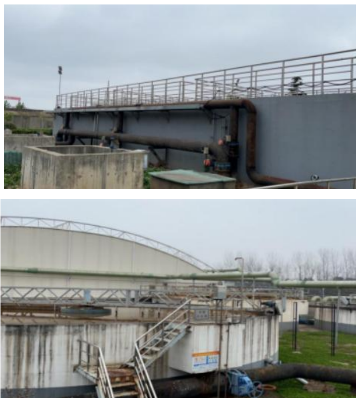
图 2.4.7-5 部分老化工艺管线
