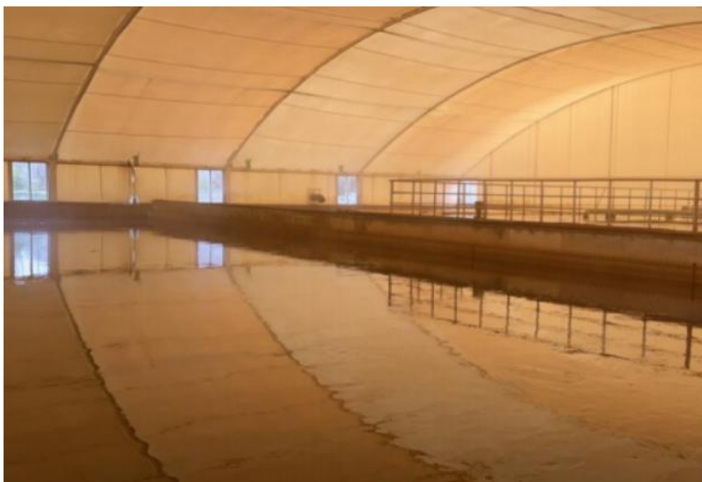
图 2.4.7-1 现状臭氧氧化池
