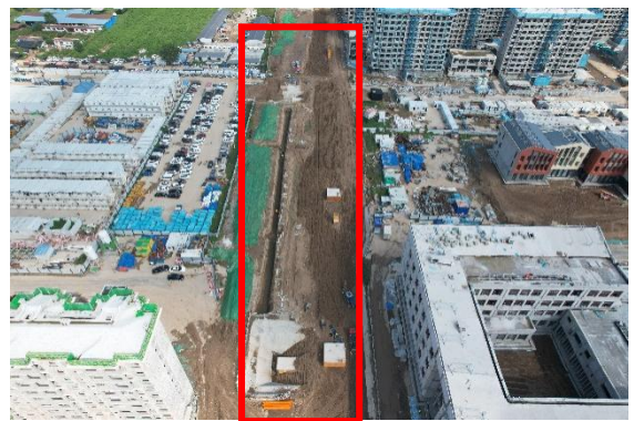
N5 路综合管廊，2023.10，镜像北
