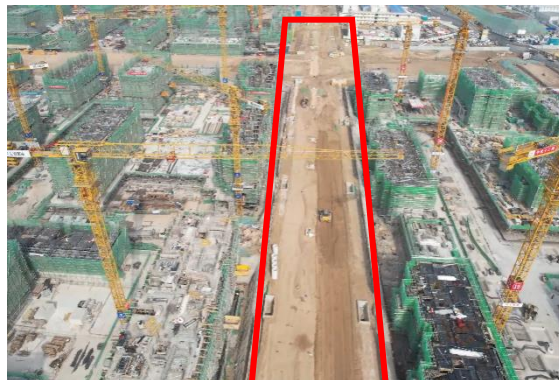
N6 路组合排管，2023.04，镜像南
