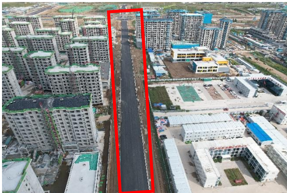
N6 路组合排管，2023.09，镜像南
