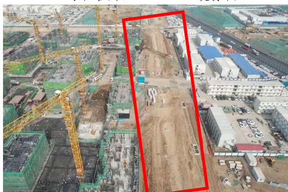
E10 路组合排管，2023.04，镜像西
