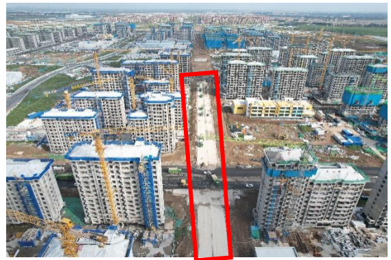
N7 路综合管廊，2023.09，镜像北
