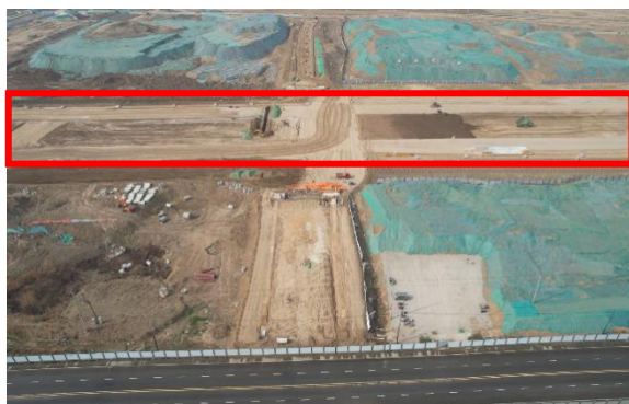
E3 路综合管廊，2023.04，镜像北
