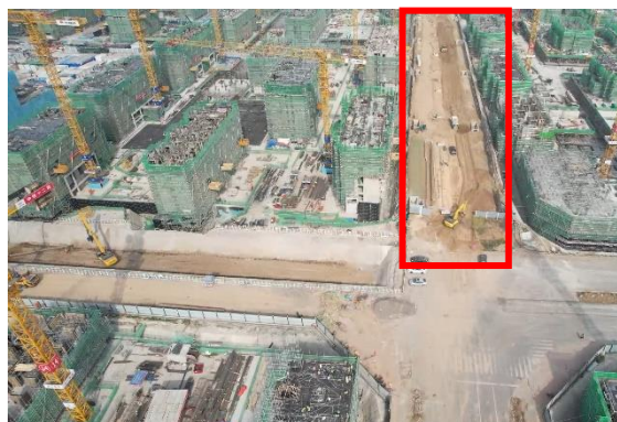
N5 路组合排管，2023.04，镜像南
