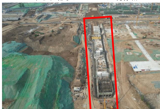
N5 路综合管廊，2023.04，镜像北
