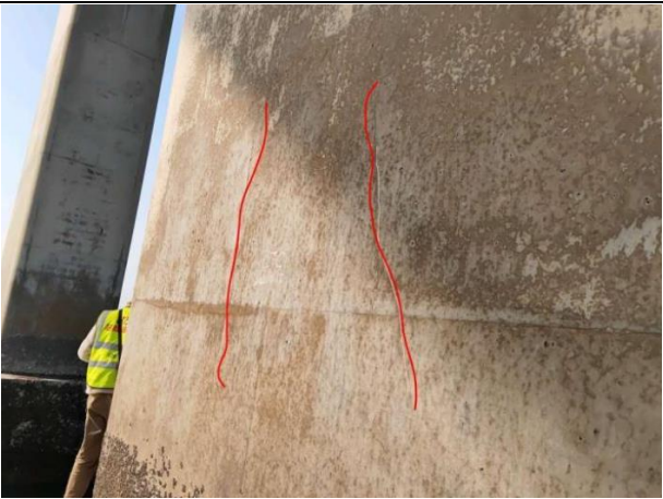
图 9-24 墩身竖向裂缝
