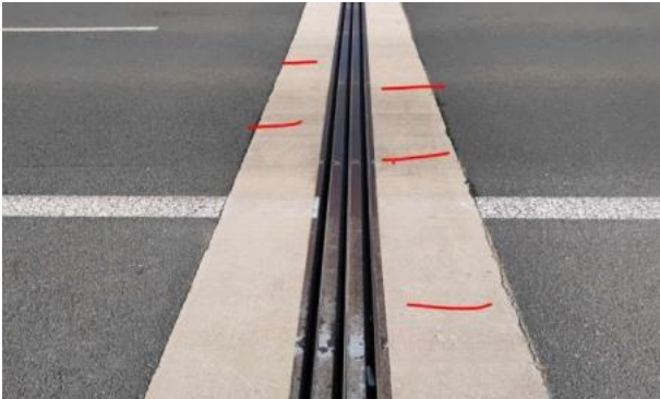
图 9-41 引桥伸缩缝锚固区开裂
