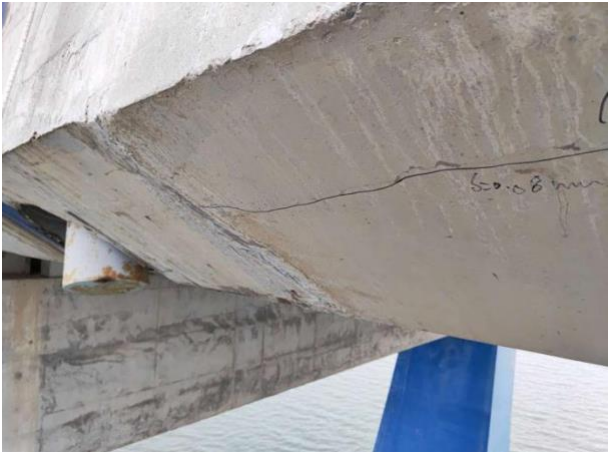
图 9-3 节段梁纵向裂缝
