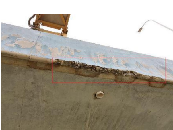
图 9-20 左侧滴水沿混凝土剥落
