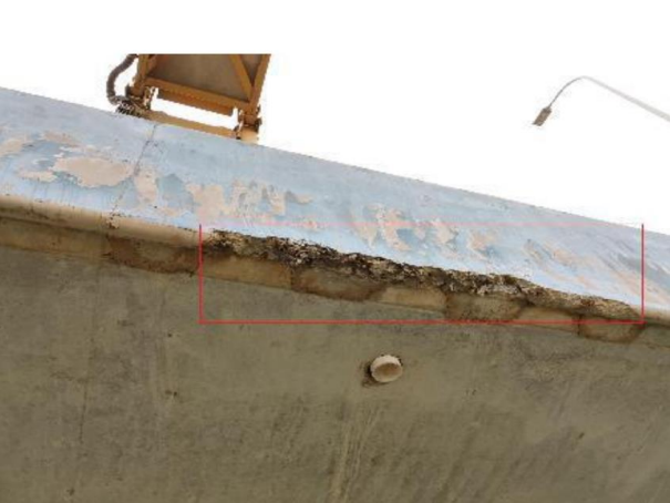
图 9-50 滴水沿混凝土剥落
