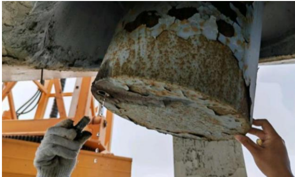
图 9-9 斜拉索锚头现状
