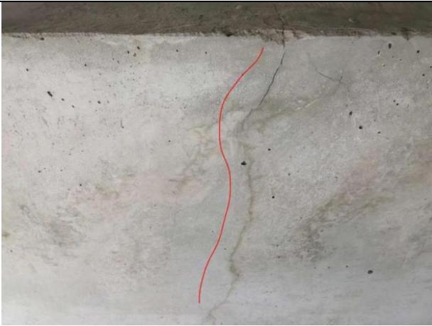
图 9-23 墩身竖向裂缝
