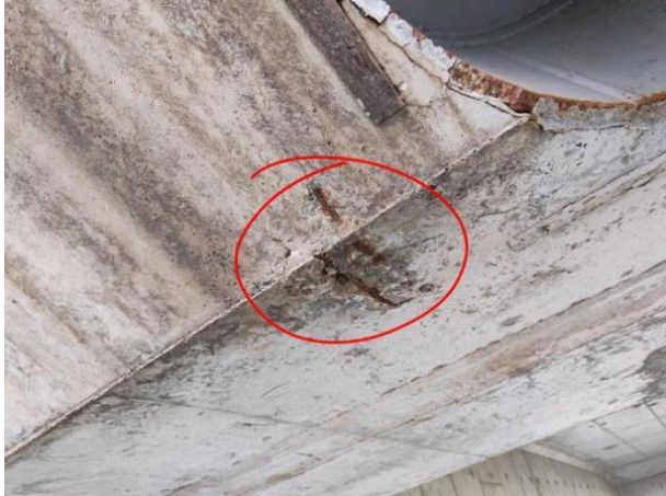
图 9-4 节段梁钢筋锈蚀
