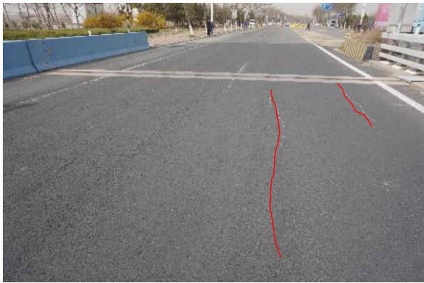
图 9-35 桥面铺装纵裂
