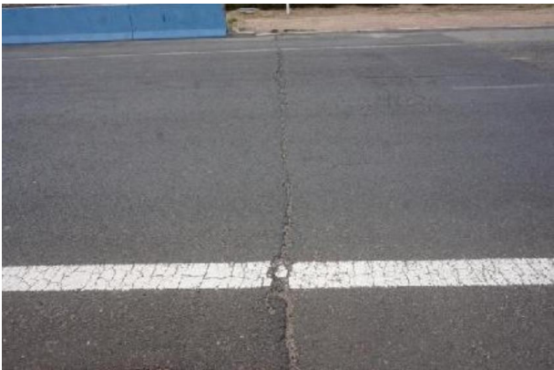
图 9-34 桥面铺装横裂
