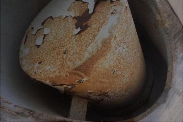
图 9-8 锚头护筒出现锈蚀
