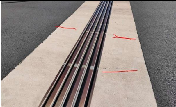
图 9-38 主桥伸缩缝锚固区开裂
