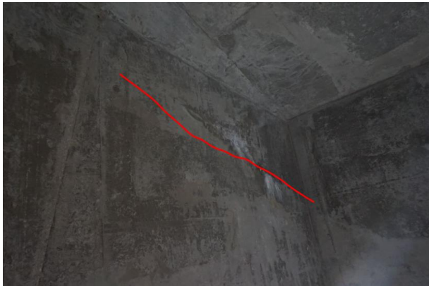
图 9-2 右侧纵梁纵向裂缝
