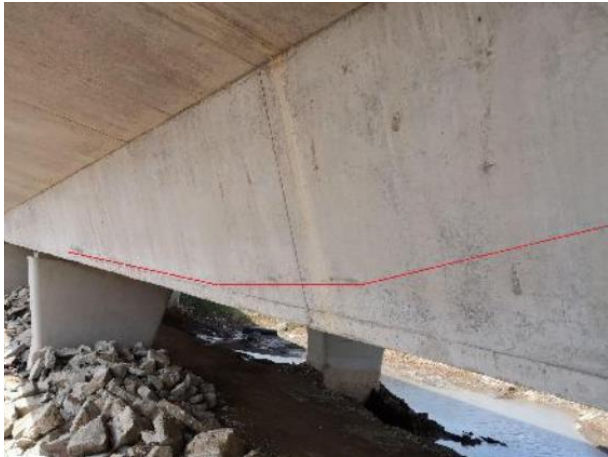
图 9-19 箱外左腹板纵缝
