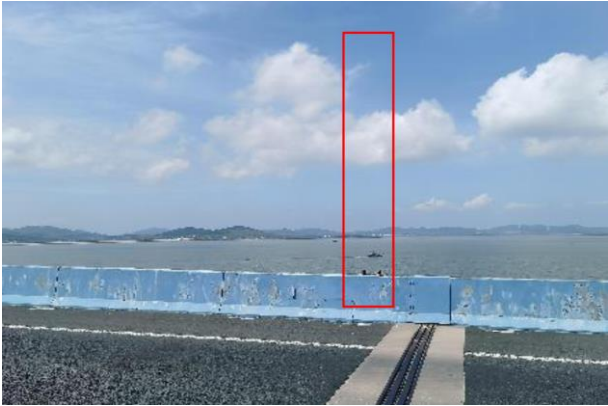
图 9-54 48#墩顶灯杆缺失图
