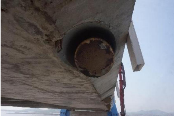
图 9-7 锚头护筒出现锈蚀
