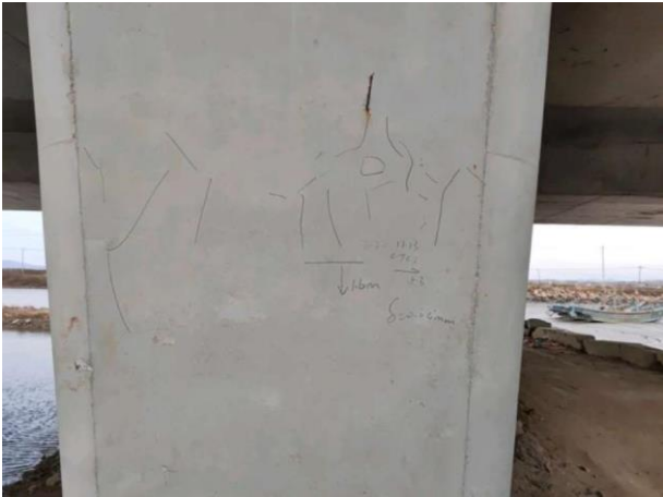
图 9-25 墩身网状裂缝
