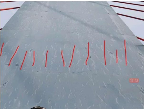
图 9-15 索塔表面裂缝
