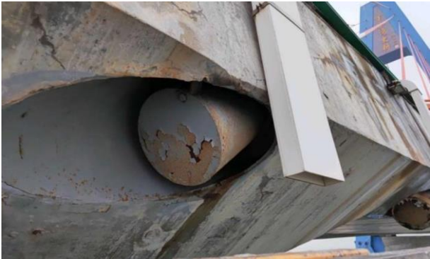
图 9-10 斜拉索锚头现状
