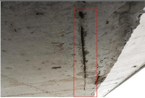
图 9-18 #箱外底板锈胀露筋
