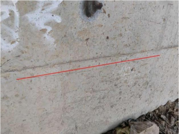
图 9-26 墩身横向裂缝
