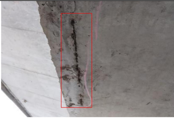
图 9-17 箱外底板锈胀露筋
