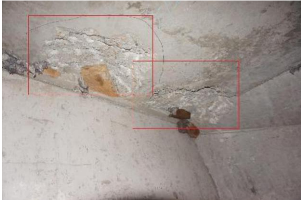
图 9-21 箱内顶板混凝土破损
