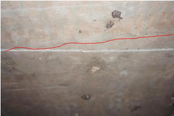
图 9-22 箱内顶板纵向裂缝
