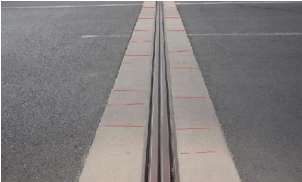
图 9-40 引桥伸缩缝锚固区开裂
