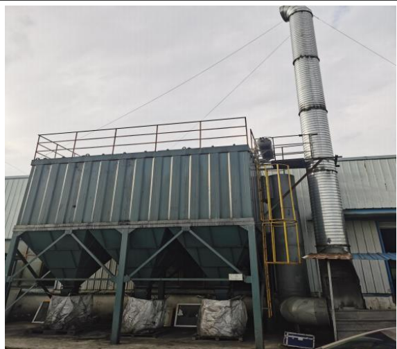
（投料、混料、提升及破碎粉尘布袋除尘器处理设备及 DA001 排气筒）
