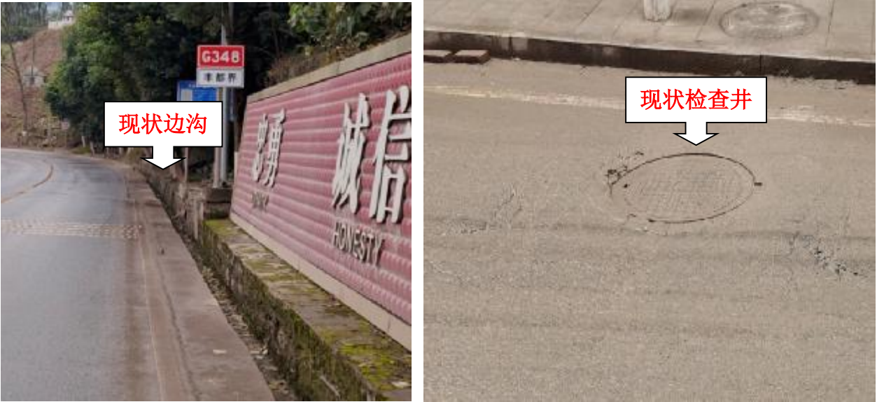
旧路面现状排水设施
