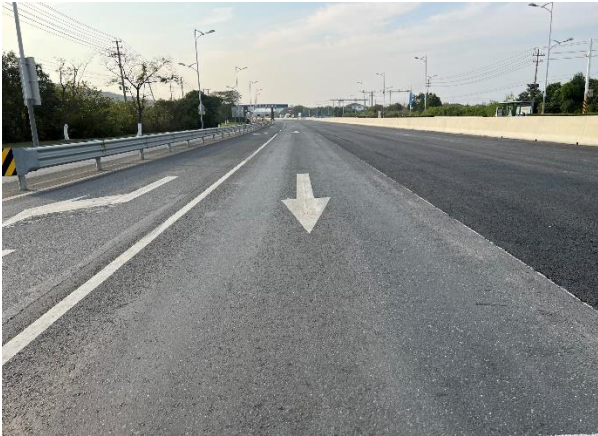
一般路段磨耗性车辙病害
