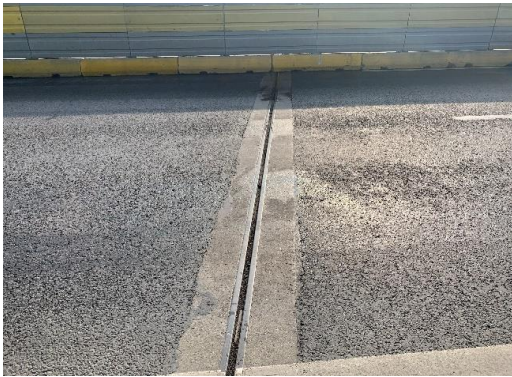
伸缩缝砂砾堵塞
