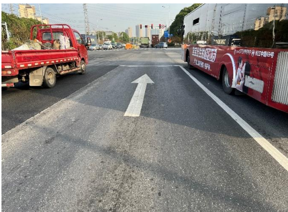
交叉口失稳性车辙病害
