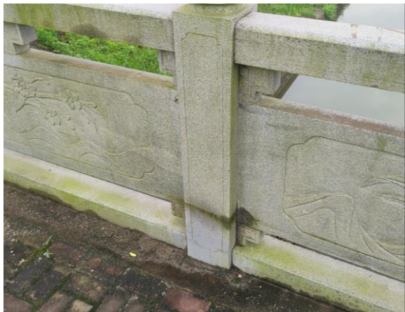
花岗岩护栏多处断裂
