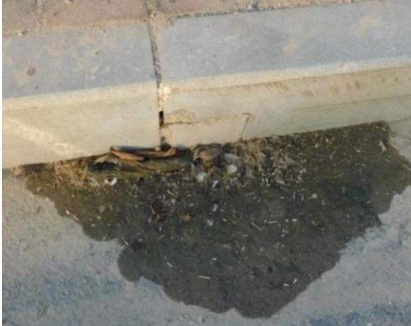
梁底混凝土剥落、破损
