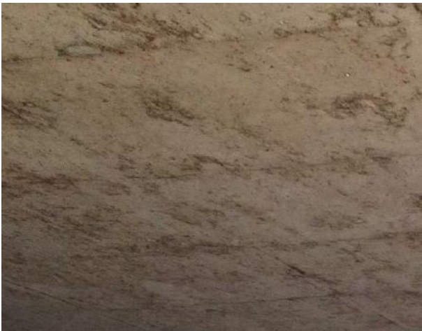
主梁梁底多处蜂窝麻面
