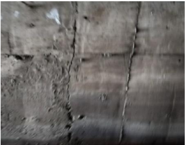
箱涵变形缝处裂缝
