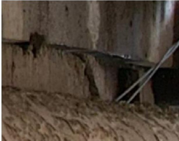
西幅桥桥台角部结构性裂缝
