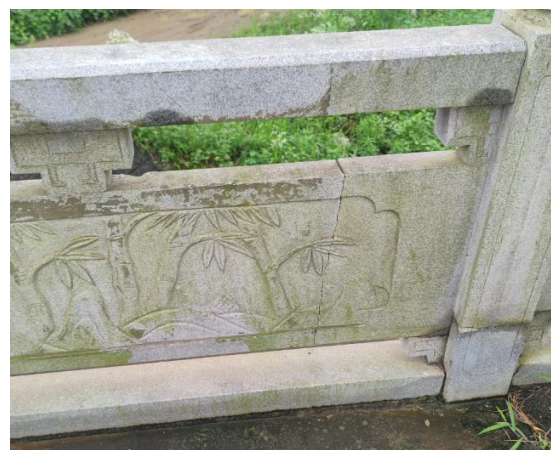
花岗岩护栏多处断裂
