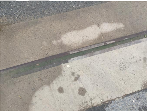
伸缩缝堵塞卡死、止水带老化
