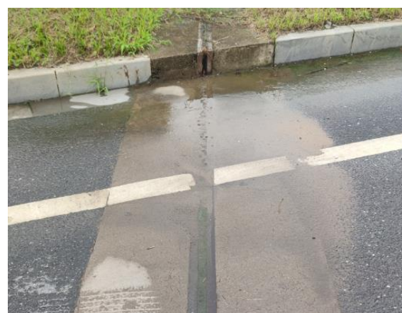
泄水孔堵塞、雨水箅子缺失
