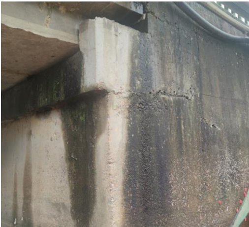
桥台局部混凝土碳化、破损
