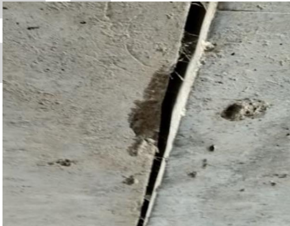
梁底混凝土剥落、破损
