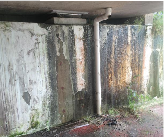
桥台混凝土表面腐蚀
