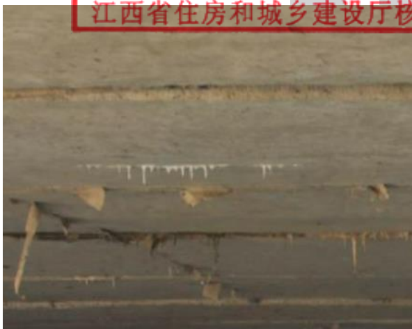
东幅桥梁底铰缝纵向裂缝、渗水结晶
