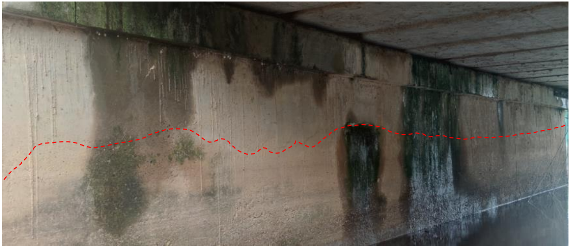
西幅桥南侧桥台左侧墙起至桥台中部水平向裂缝，台身局部空洞
