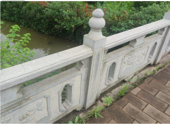
栏杆高度不足
