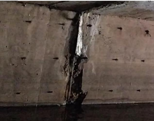
节段交接处涵身体破损、变形缝漏水
