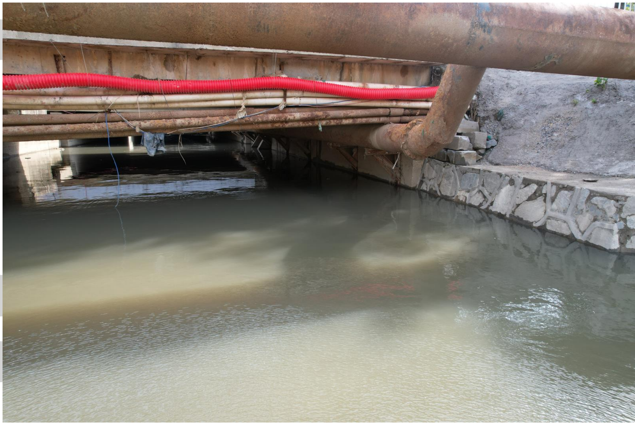
西幅桥桥台角部结构性裂缝
