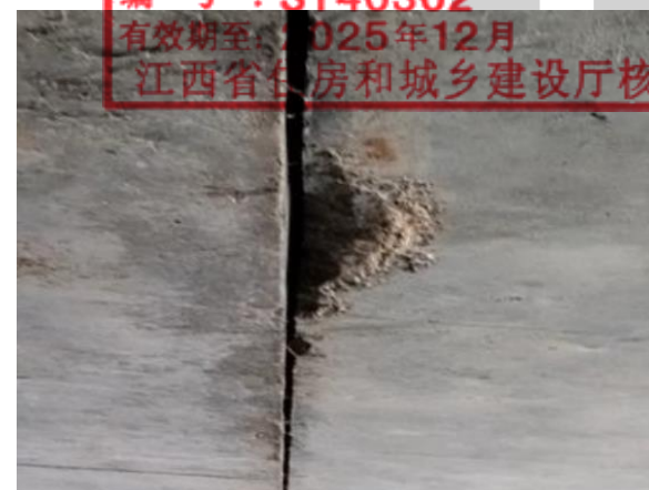
梁底混凝土剥落、破损
