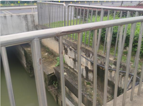
复合管栏杆锈蚀
