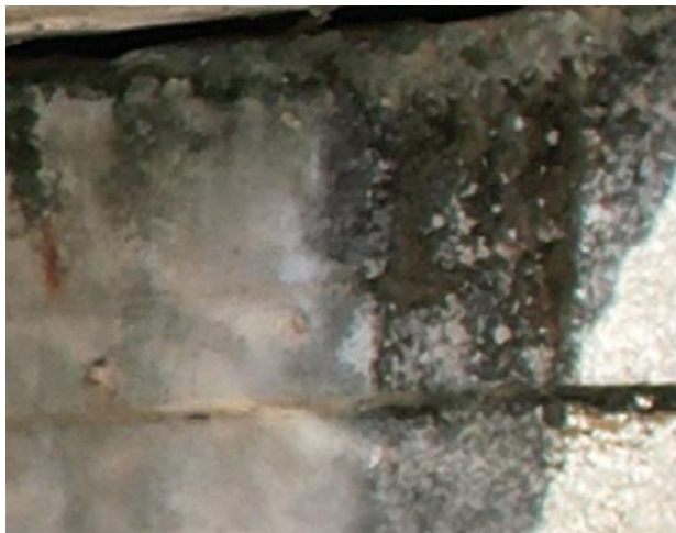
桥台混凝土碳化、破损、露筋
