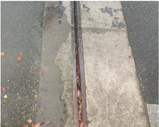
伸缩缝止水带老化开裂脱落
