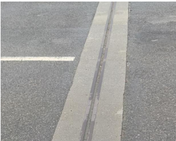
中幅桥伸缩缝堵塞卡死
