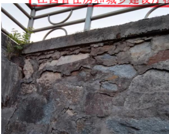
桥台翼墙砌石松动
