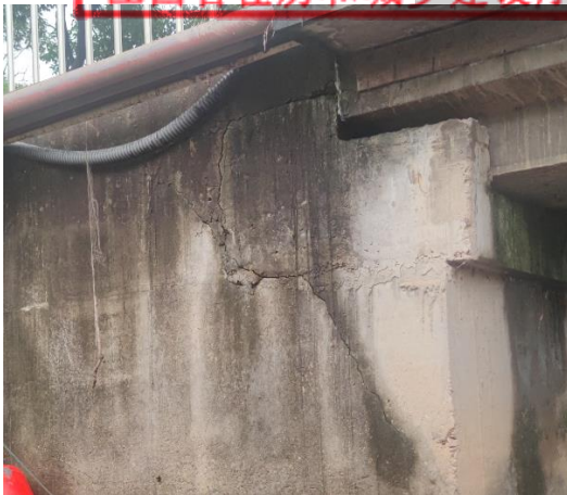
西幅桥南侧桥左侧墙结构裂缝
