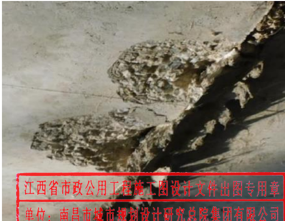
梁底混凝土剥落、破损
