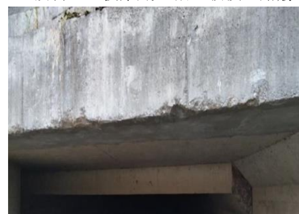
北侧节段外边缘破损
