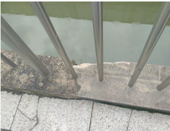
栏杆基础混凝土破损
