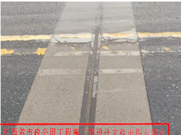
伸缩缝锚固区砼破损、开裂
