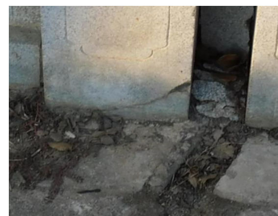
花岗岩护栏立柱多处断裂
