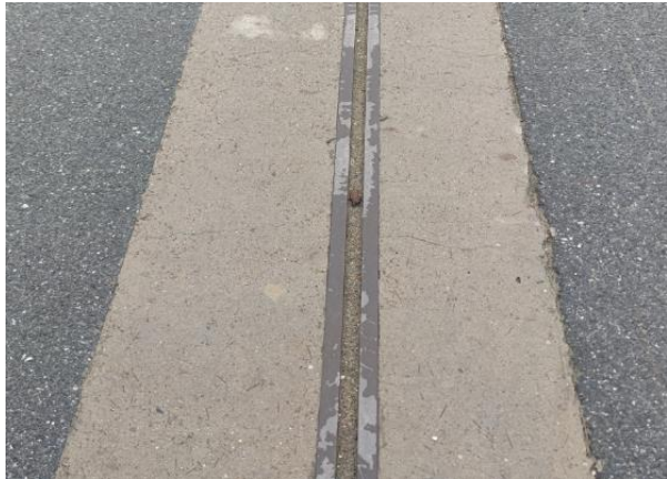
伸缩缝堵塞卡死、止水带老化
