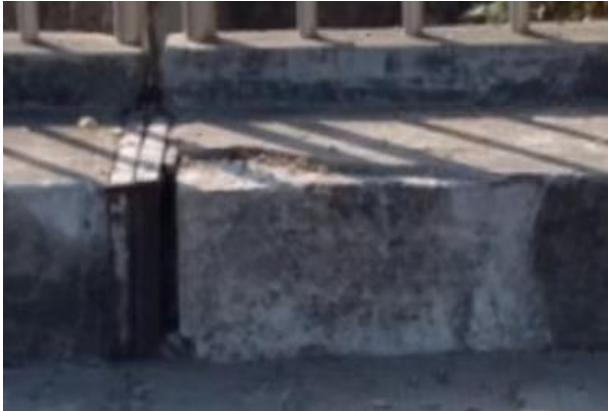
栏杆基础混凝土破损
