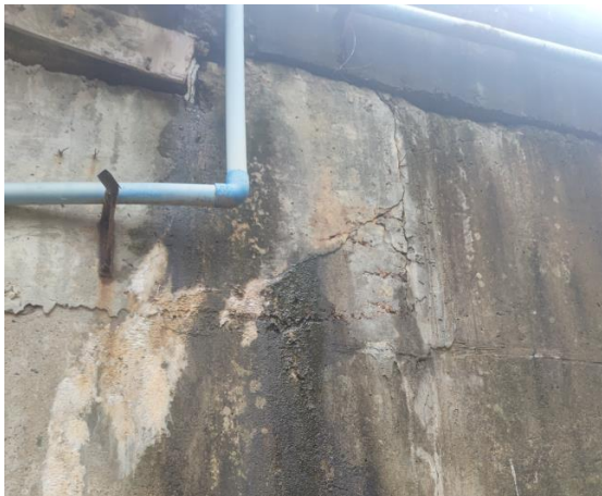
中幅桥南侧桥右侧墙结构裂缝
