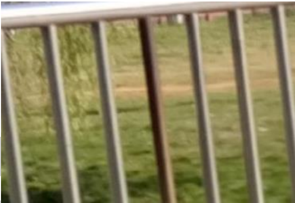
复合管栏杆锈蚀
