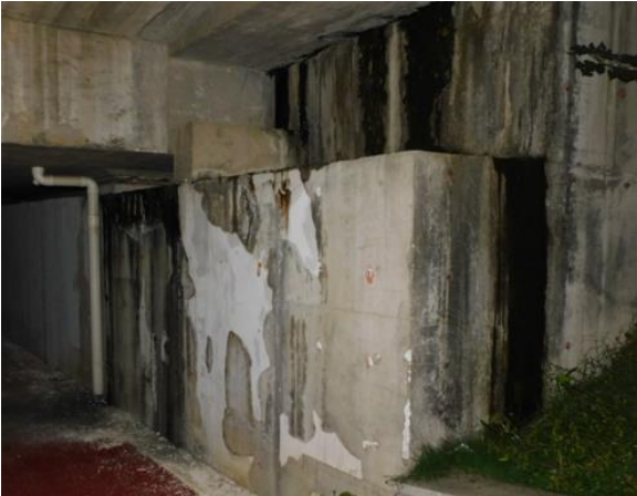
桥台混凝土表面腐蚀
