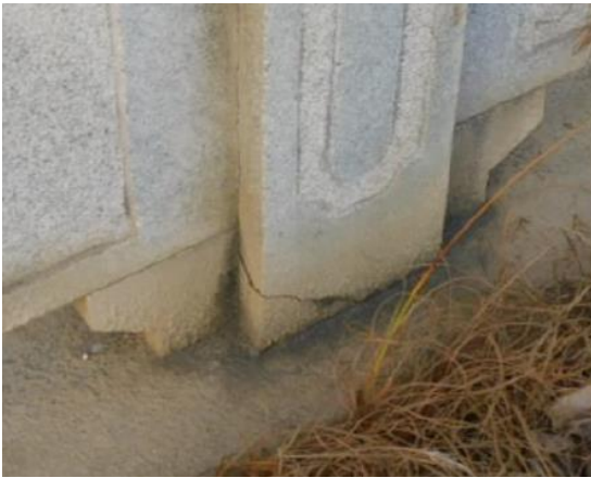
花岗岩栏杆个别立柱断裂
