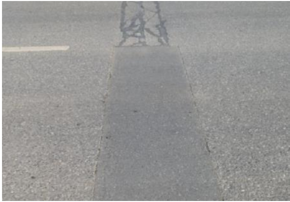
中幅桥伸缩缝失效
